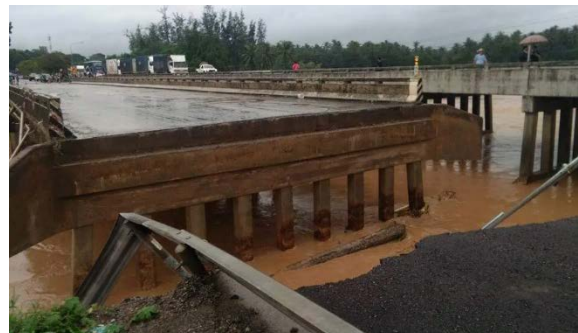
ภาพที่ ๒๑ คอสะพานที่ยื่นเข้าไปในลำน้ำ หนาน้ำหลาก จะถูกน้ำกัดเซาะ ตัดขาด
