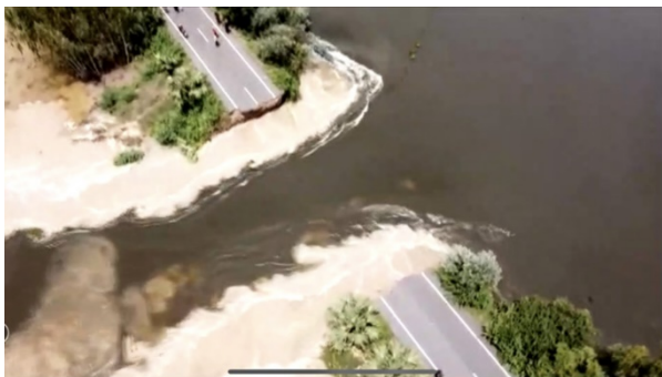
ภาพที่ ๒๐ ถนนที่สร้างขวางลำน้ำ เมื่อน้ำหลากทำให้ถนนขาด
