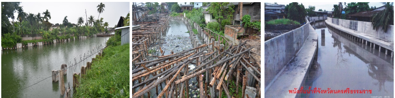
ภาพที่ ๘ พนังกั้นน้ำที่จังหวัดนครศรีธรรมราชรุกรล้ำบริเวณลำน้ำ ทำให้ทางน้ำแคบลงส่งผลให้ประสิทธิภาพการระบายน้ำลดลง
