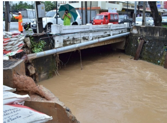
ภาพที่ ๑๙ ช่องลอดใต้สะพานที่บีบทางน้ำให้แคบลง
